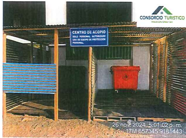
Fotografía 10: Implementación de almacén temporal de residuos.
