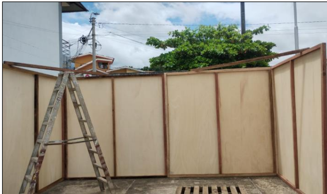
Fotografía N° 03: PAREDES DEL ALMACEN DE OBRA
